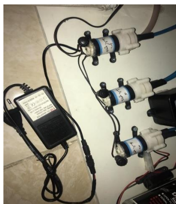
شکل ۸: پمپ های R۳۸۵ و آداپتور ۱۲ ولت
